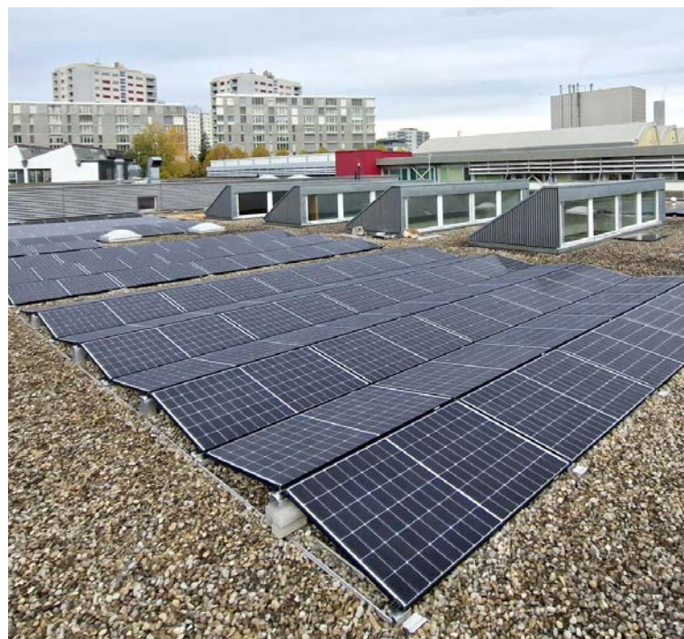
296 m 2 de panneaux photovoltaïques recouvrent le toit du CIS © CIS
